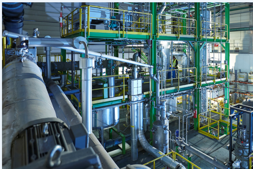
Pilotanlage in Ennigerloh, Quelle: Carboliq
