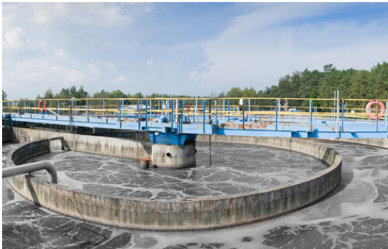
Wasseraufbereitungsanlage, Quelle: envato elements
