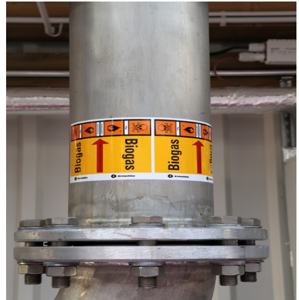
Rohrleitung Biogas, Quelle AWG
