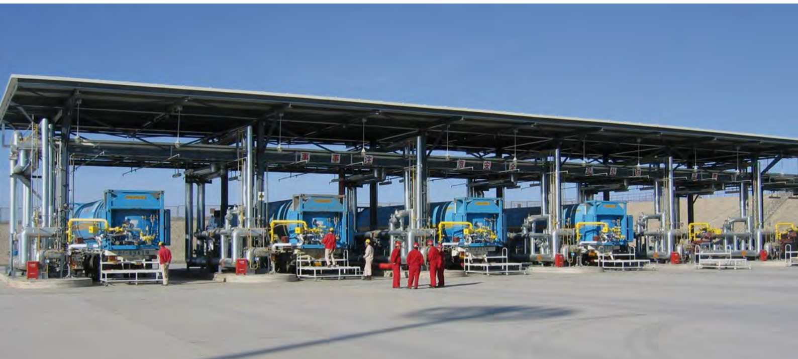
An solchen Tankstellen nehmen Trucks LNG auf. Trucks take on LNG at such filling stations.
